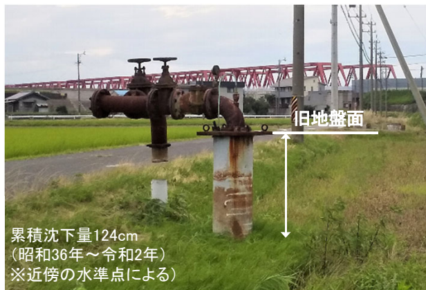
井戸の抜け上がり状況(三重県桑名郡木曾岬町) (令和3年6月撮影)
