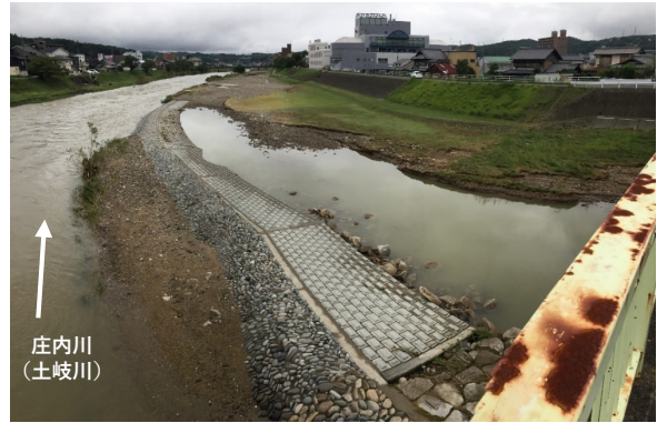
土岐津橋下流 (被災後)
