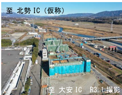
至北勢IC(仮称) 至大安IC R3.1撮影 令和6年度開通に向け工事が進む 東海環状自動車道 北勢IC～大安IC
