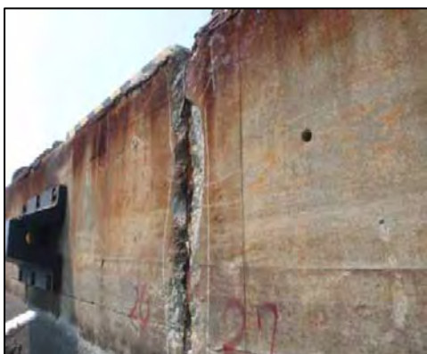
神野地区 上部工の劣化状況
