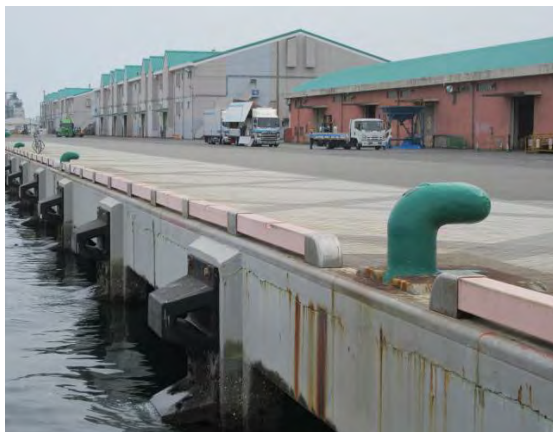
日の出地区 上部工の劣化状況
