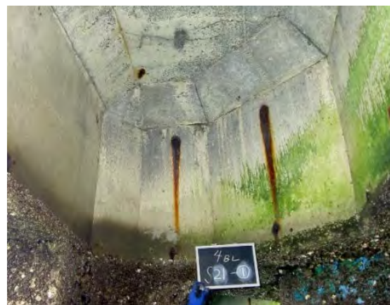
日の出地区 床版の劣化状況
