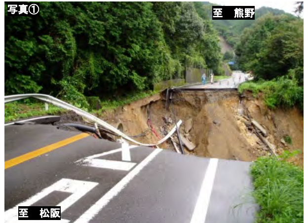
道路決壊により78時間の通行止が発生
