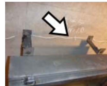
▲照明本体取付部の覆工コンクリートのひび割れ
