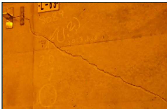
【覆工のひび割れ】
