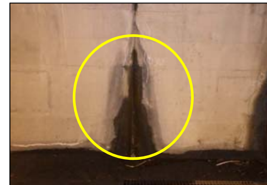
【覆工からの漏水】
