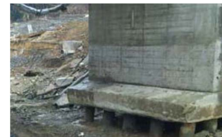
杭基礎の露出
