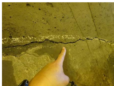
▲覆工表面のひび割れ
