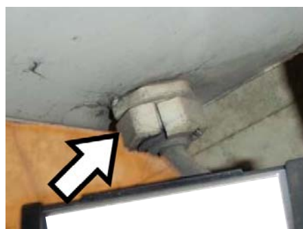
▲附属物のナットの破断
