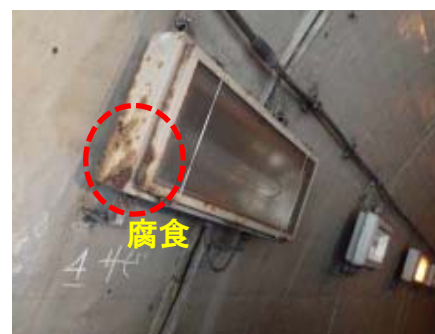
▲照明本体の腐食
