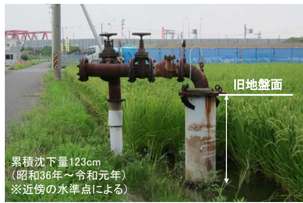
井戸の抜け上がり状況(三重県桑名郡木曾岬町) (平成 29 年 7 月撮影)
