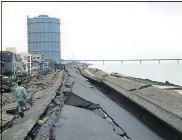
地震による堤防被災例 (平成7年1月 淀川)
