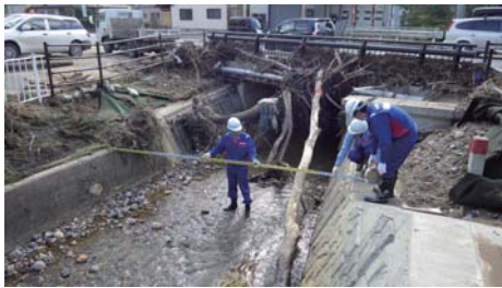
TEC-FORCEによる被災状況調査 (令和元年 台風第19号被災地)
