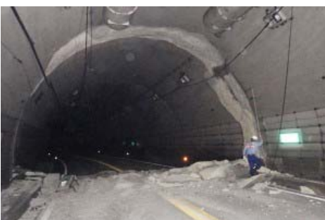
トンネル被災状況
