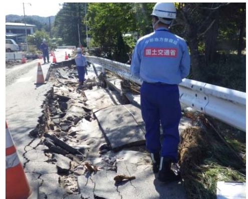
岩手県山田町での被災状況調査
