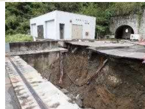
▲橋台背面土砂崩落状況
