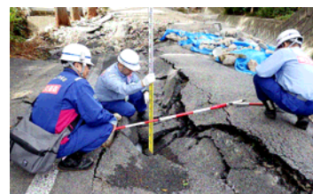
【被害状況調査】
