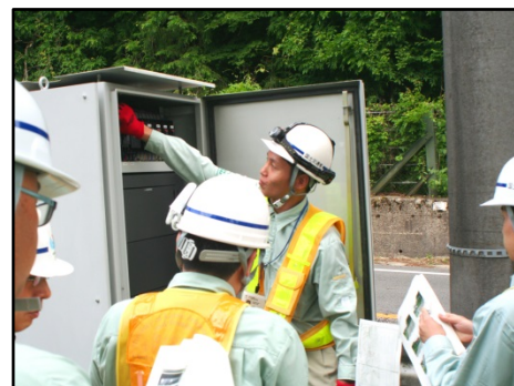
操作盤を確認
