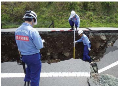
被災状況の調査
