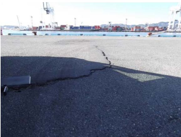
興津地区 アスファルト亀裂状況
