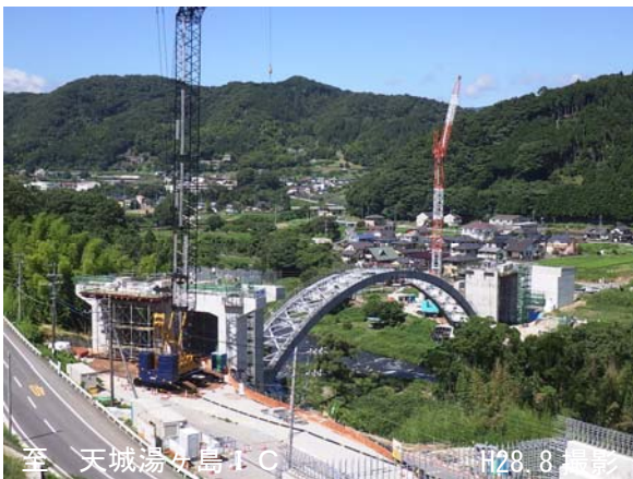
H30年度開通に向け橋梁工事が進む 天城北道路 狩野川横断高架橋
