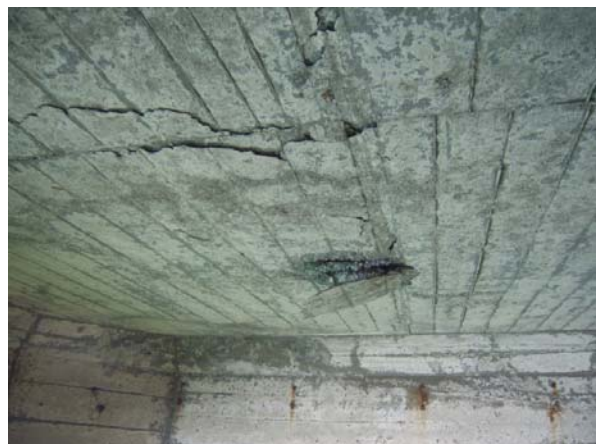
興津岸壁 床版剥落・鉄筋露出状況
