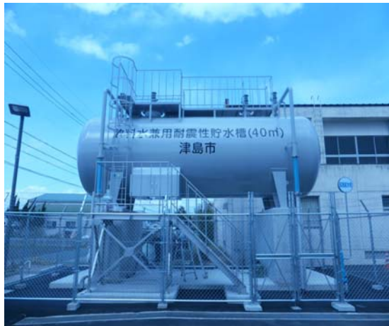
↑ 高台寺小学校に設置した貯水槽
