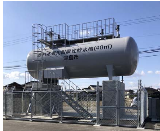
↑ 神島田小学校に設置した貯水槽
