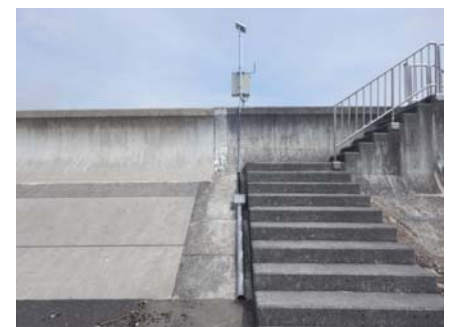
危機管理型水位計設置状況写真 (木曽川左岸4.8k)
