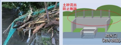
取水門の被災状況
