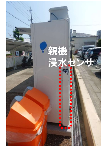
＜自動販売機側 浸水センサ 1段＞
