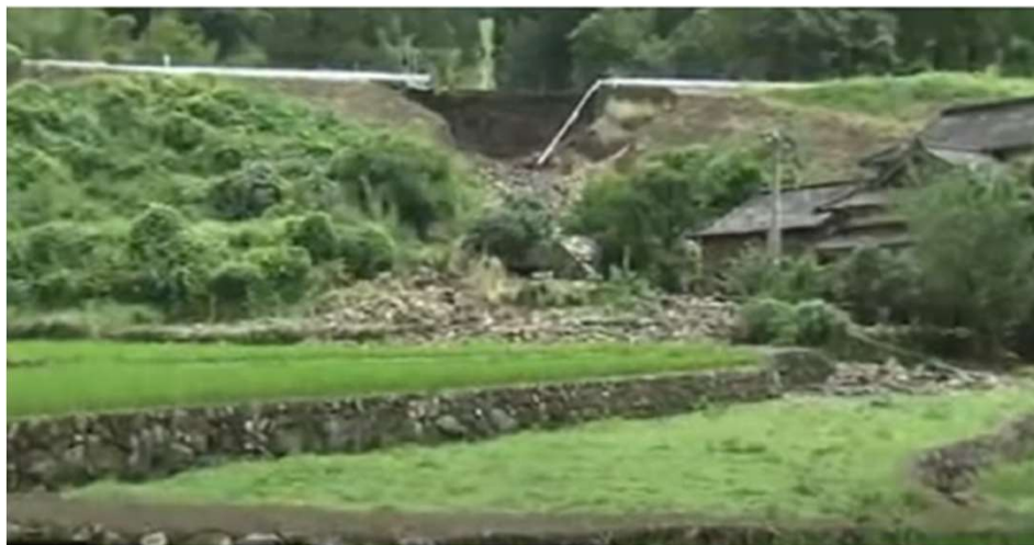
東峰村 バス専用道路の崩落
