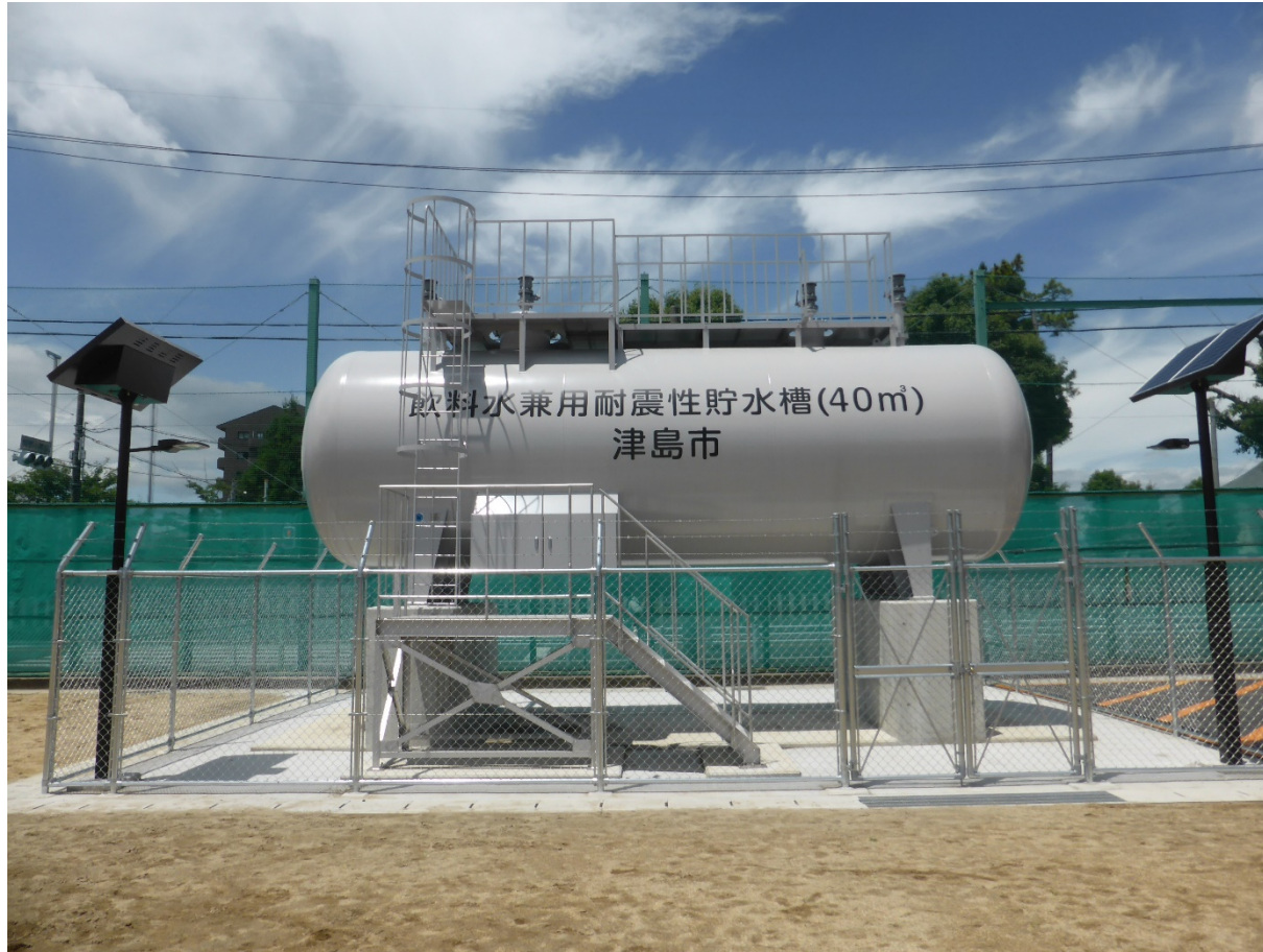
↑ 蛭間小学校に設置した耐震性貯水槽
