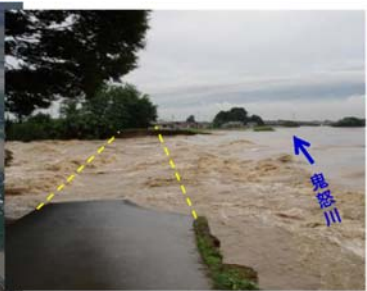
被災状況(拡大写真)
