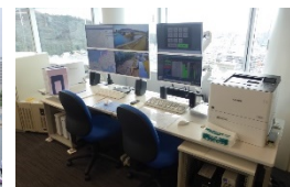
樋門管理システム
