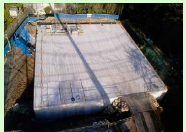
赤坂雨水調整池
