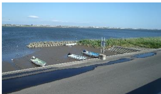
土砂堆積した変形護岸
