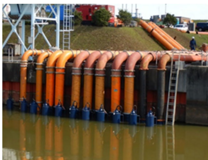
仮設ポンプイメージ
