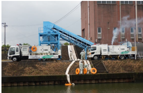
排水ポンプ車 配備状況
