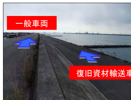
河川敷道路、天端道路の通行車両の規制 (木曾川左岸3.0k付近)
