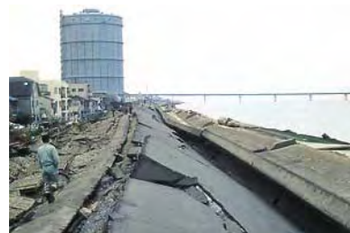
阪神・淡路大震災西島地区沈下状況(約3.0m沈下)
