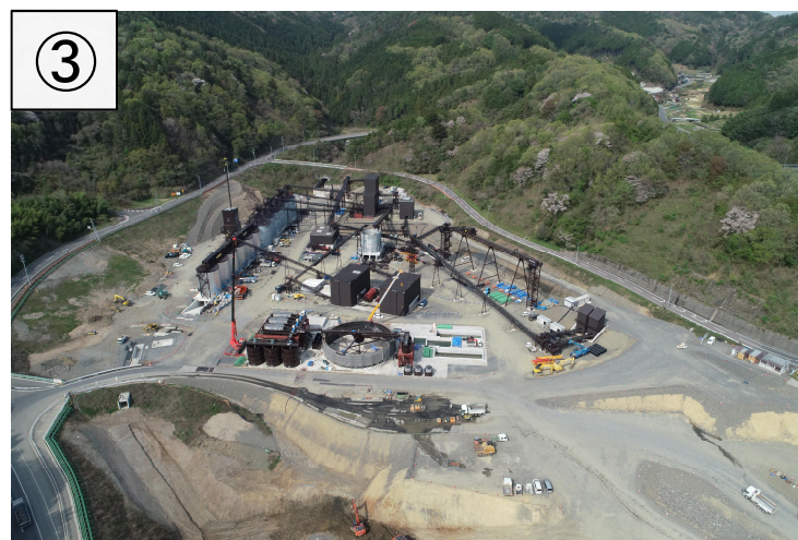
骨材製造設備
