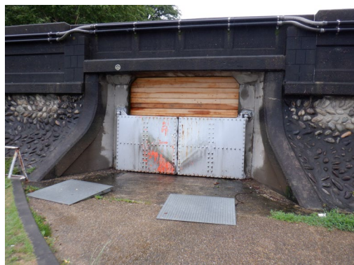
起陸閘の閉鎖状況
