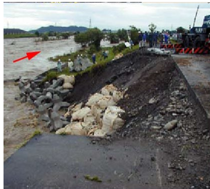
堤防の一部損傷
