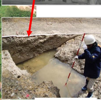
減勢工の損傷状況(横山ダム)
