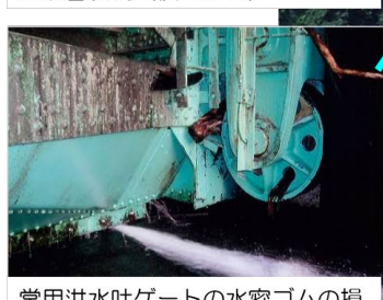
常用洪水吐ゲートの水密ゴムの損傷状況(丸山ダム)
