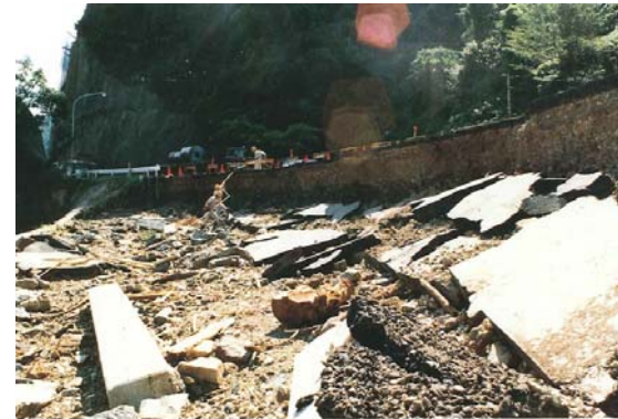
坂祝町内 被災状況
