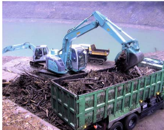
流木の除去状況
