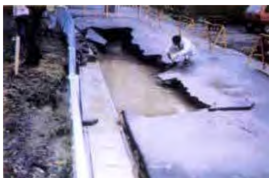
漏水事故による周辺の被害状況
