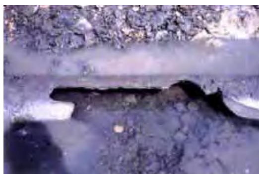
石綿セメント管の破損状況
