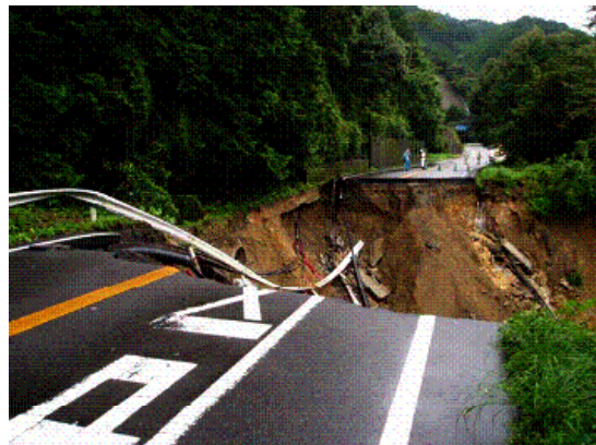
一般国道 42 号北牟婁郡海山町便ノ山における道路決壊
