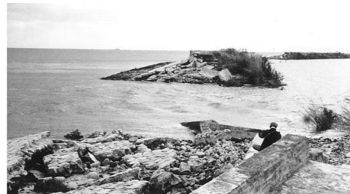
昭和34年9月伊勢湾台風による高潮堤防の被災状況
