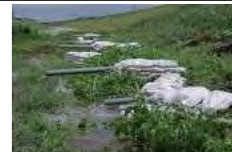
堤防からの漏水（牧田川右岸9.0k）
