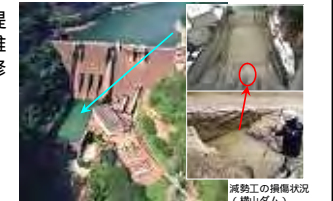
河工の損傷状況(横山ダム)
