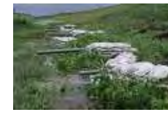
堤防からの漏水 (牧田川右岸9.0k)
