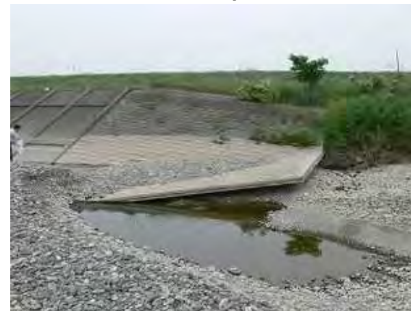
低水護岸損傷(揖斐川左岸46.8k+70)
