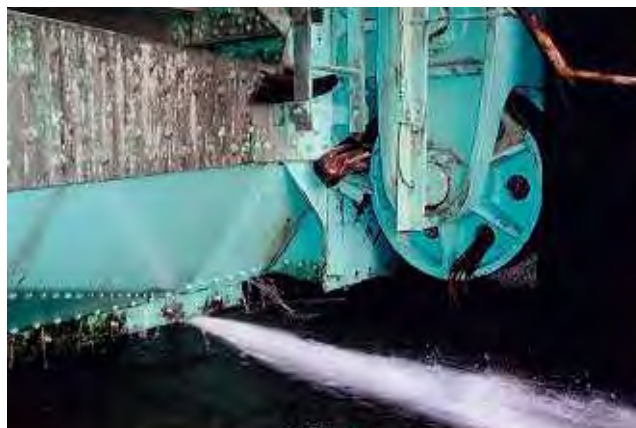
常用洪水吐ゲートの水密ゴムの劣化による漏水の状況（丸山ダム）
