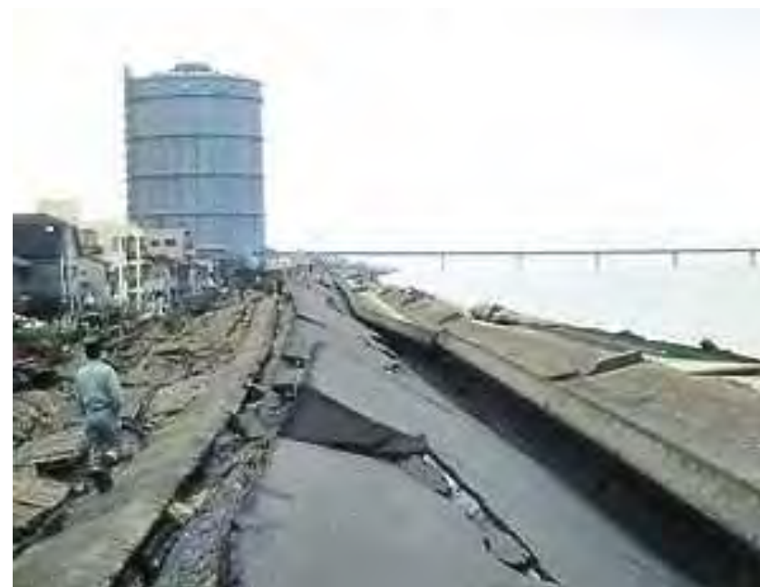
堤防沈下 淀川左岸1.0km付近（平成7年兵庫県南部地震）
