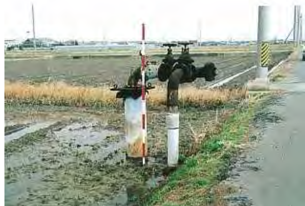
地盤沈下による井戸の抜け上り状況（木曾岬町）
