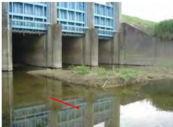
樋管吐出口の堆砂状況写真 (長良川右岸47k:両満川排水樋管)
