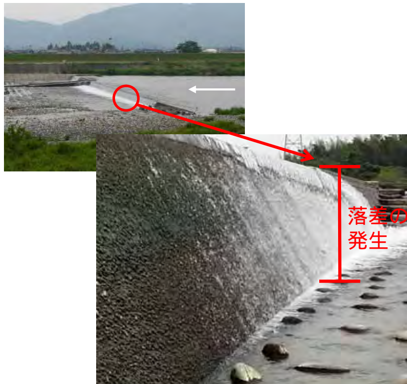
根尾川第7床固（7.8k付近） 落差は1.3mあり、魚類等の遡上は困難
