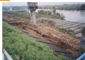
揖斐川流木の状況(34.6k左岸付近)
