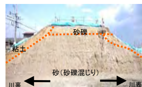
砂等で構成された脆弱な堤防
