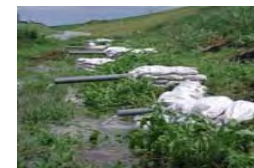
堤防からの漏水 (牧田川右岸9.0k)
