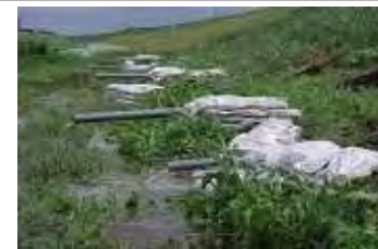
堤防からの漏水（牧田川右岸9.0k）
