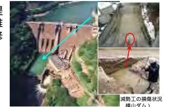
減勢工の損傷状況 横山ダム
