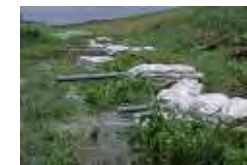
堤防からの漏水 (牧田川右岸9.0k)
