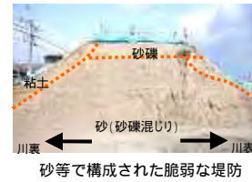
砂等で構成された脆弱な堤防
