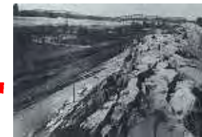
濃尾地震による長良川鉄橋 (東海道本線)と堤防の被害状況
