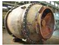
老朽化した排水機場の排水ポンプ (糸貫川天王川排水機場)
