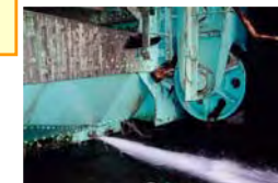
常川洪水吐ゲートの漏水の状況 (丸山ダム)
