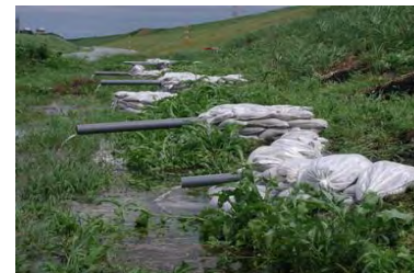
堤防からの漏水(牧田川右岸9.0k)
