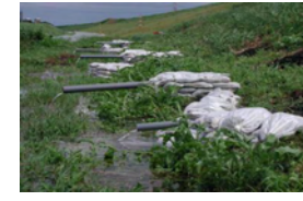
堤防からの漏水 (牧田川右岸9.0k)
