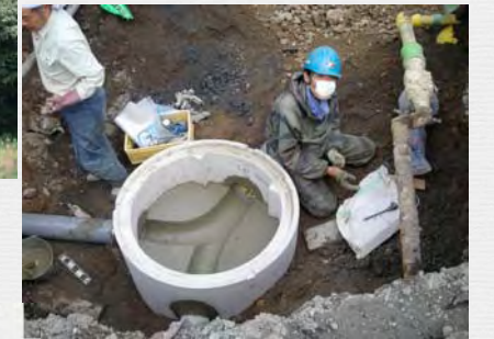
岐阜市下水道 (昭和13年) 日本初の分流式下水道
