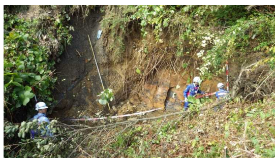
被災状況調査状況 (久慈市宇部町地先 北の越川 河岸洗掘 深掘れ)
