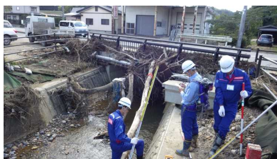
被災状況調査状況 (久慈市宇部町地先 北の越川 流木堆積)
