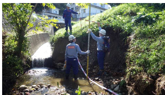
被災状況調査状況 (久慈市 西の沢川 石積み崩落)
