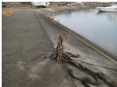
係留杭の設置による護岸損傷
