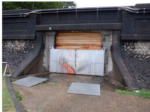
起陸閘の閉鎖状況
