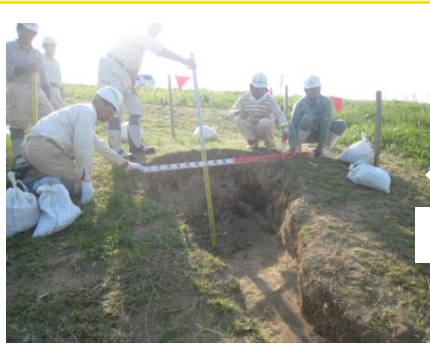
陥没の発見(詳細調査状況)
