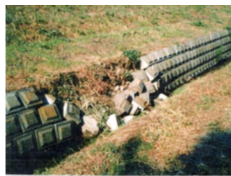
堤脚ブロックの崩れ
