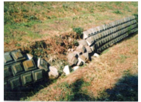
堤脚ブロックの崩れ
