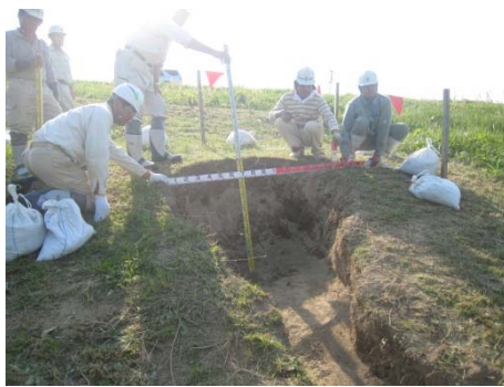
陥没の発見(詳細調査状況)
