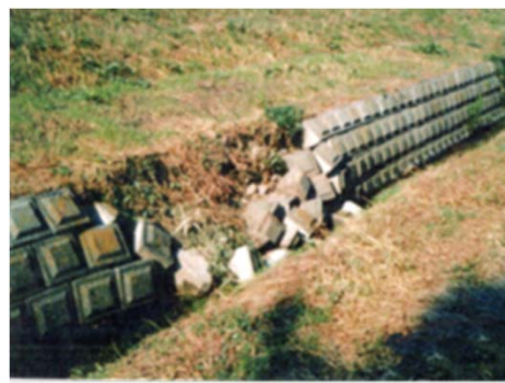
堤脚ブロックの崩れ
