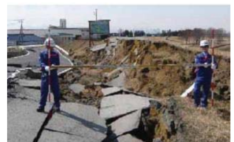
被災状況調査状況（熊野市）
