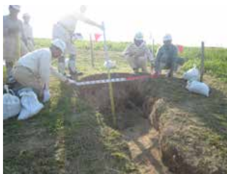
陥没の発見(詳細調査状況)
