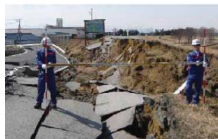
被災状況調査状況(熊野市)
