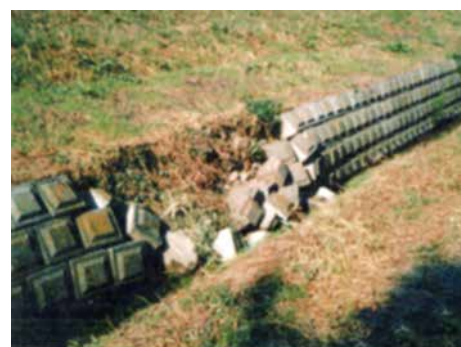
堤脚ブロックの崩れ
