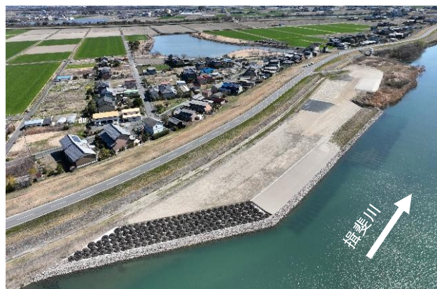
揖斐川帆引新田地区堤防整備事業(箇所:海津市) 令和8年3月撮影
